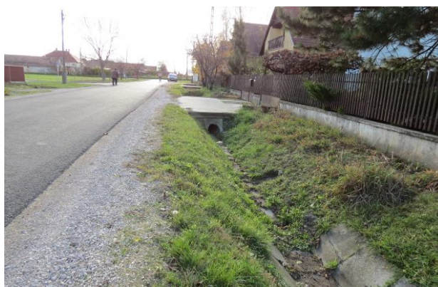
Csapadékvíz elvezető nyílt árok a Bethlen Gábor utcában
